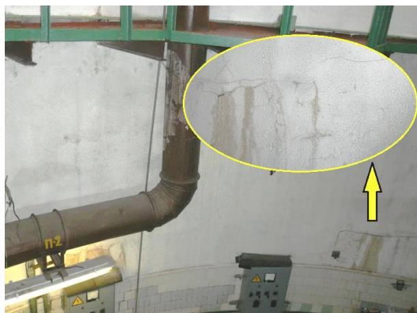
Рисунок 3 – Кольцевые трещины со следами протечек в стенах машинного зала подземного резервуара
