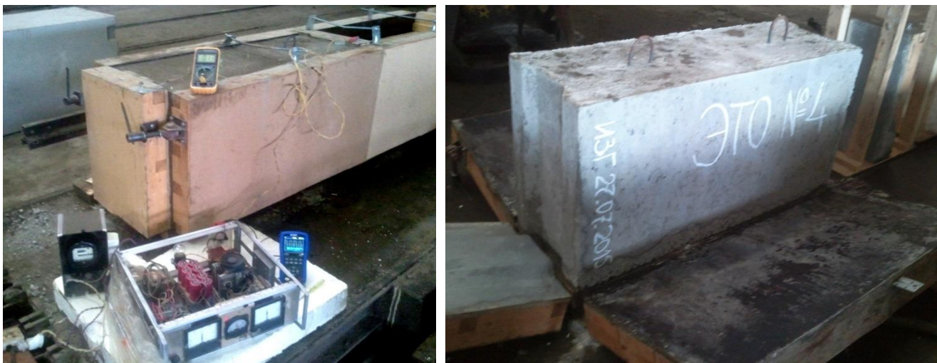
Рисунок 2 - Внешний вид опалубки в процессе ЭТО при изготовлении фундаментных блоков типа ФБС 12.4.6 в начальный момент (слева) и готового изделия после распалубки (справа): на рисунке слева на переднем плане слева направо – счетчик электроэнергии, источник питания повышенной частоты мощностью 4,5 кВт и портативный осциллограф для регистрации напряжения на электродах опалубки
