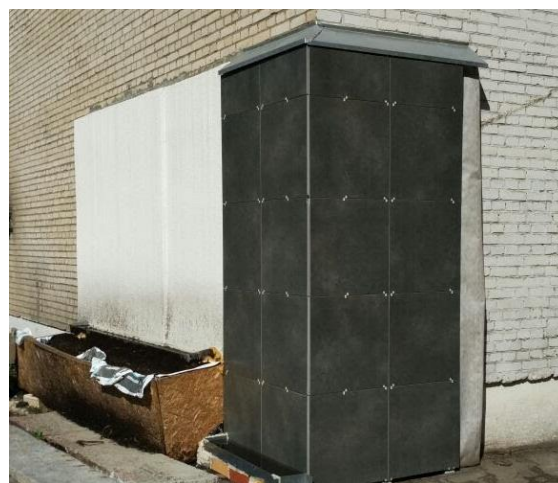
Рисунок 2 - Экспериментальный стенд, смонтированный на стене акустического корпуса
